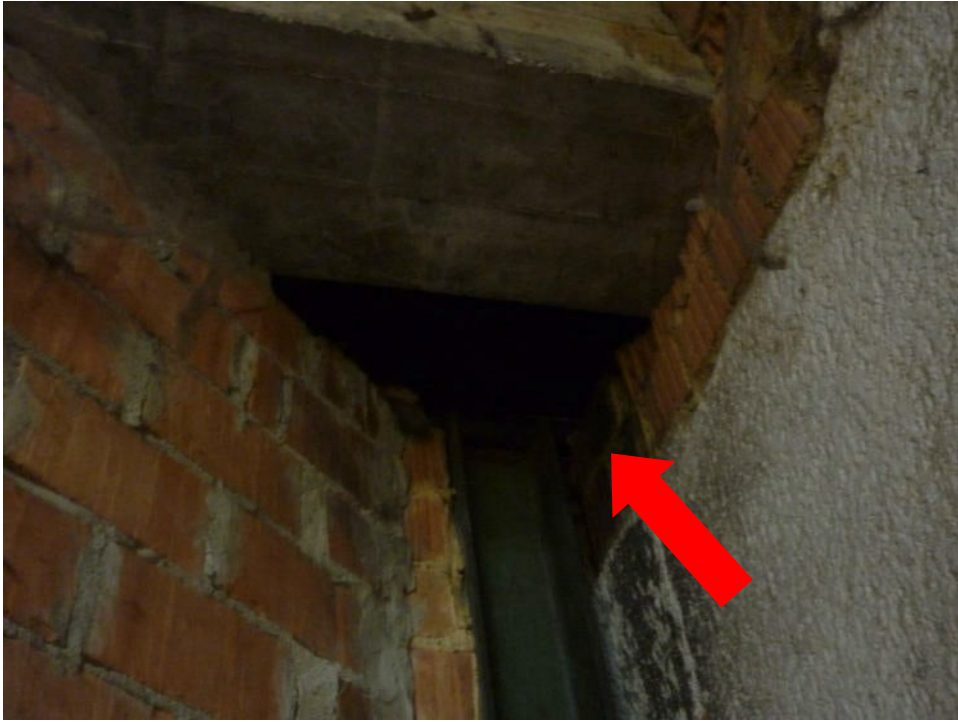
Abbildung 2-8: Übergang der Lagerhalle zum Verwaltungsgebäude. Hier ist ein ca. 30x30 cm großes Loch. Es führt zu einem Hohlraum, der Quartierpotential bietet. Hier können aber Waschbären und andere Kleinsäuger eindringen.
