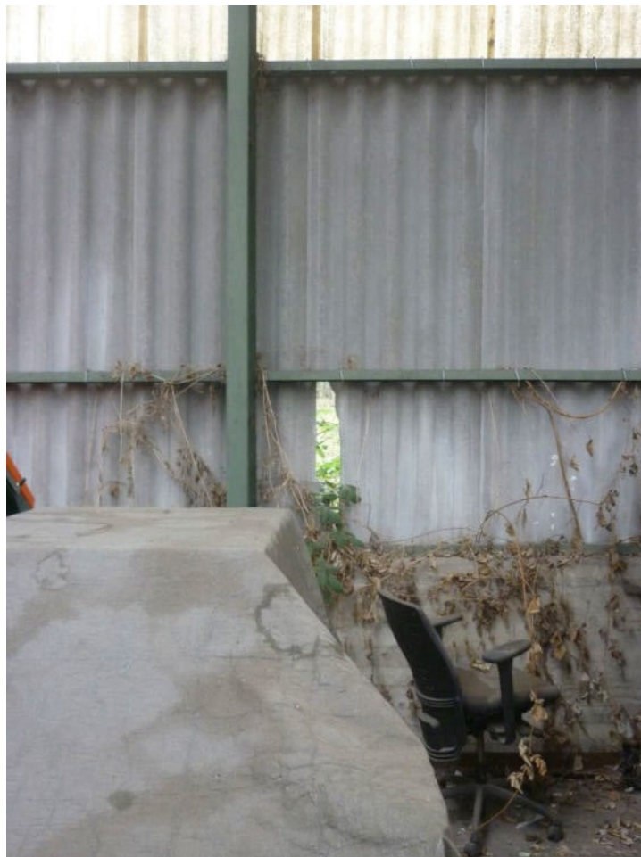
Abbildung 2-7: Loch in der Wandverkleidung der Abstellhalle, die einen Zugang zum Halleninneren ermöglicht
