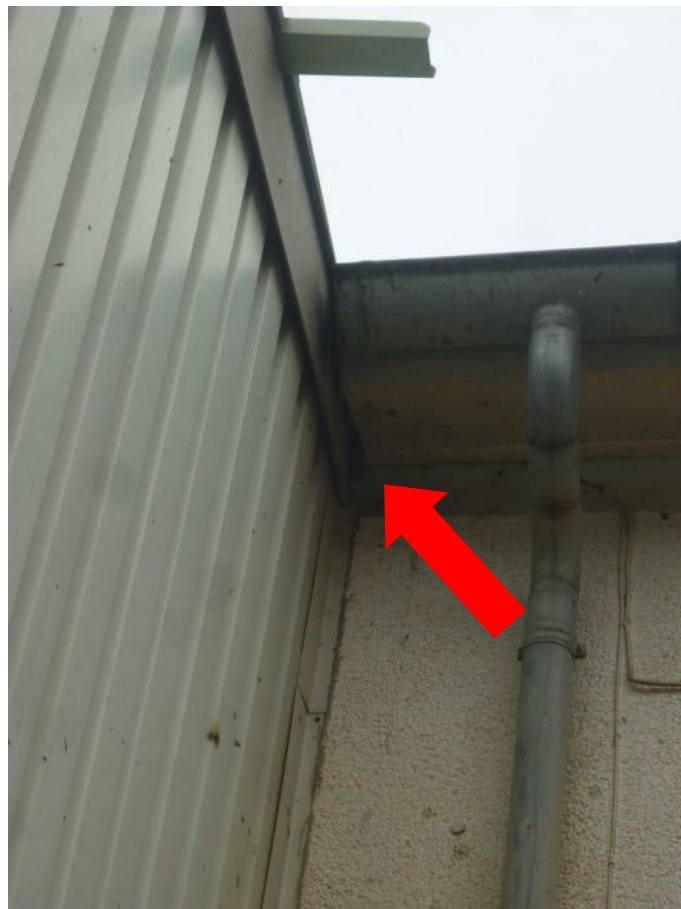
Abbildung 2-5: Übergang Lagerhalle Verwaltungsgebäude. Hier sind Spalten vorhanden, die von Fledermäusen als Ruhestätte genutzt werden können
