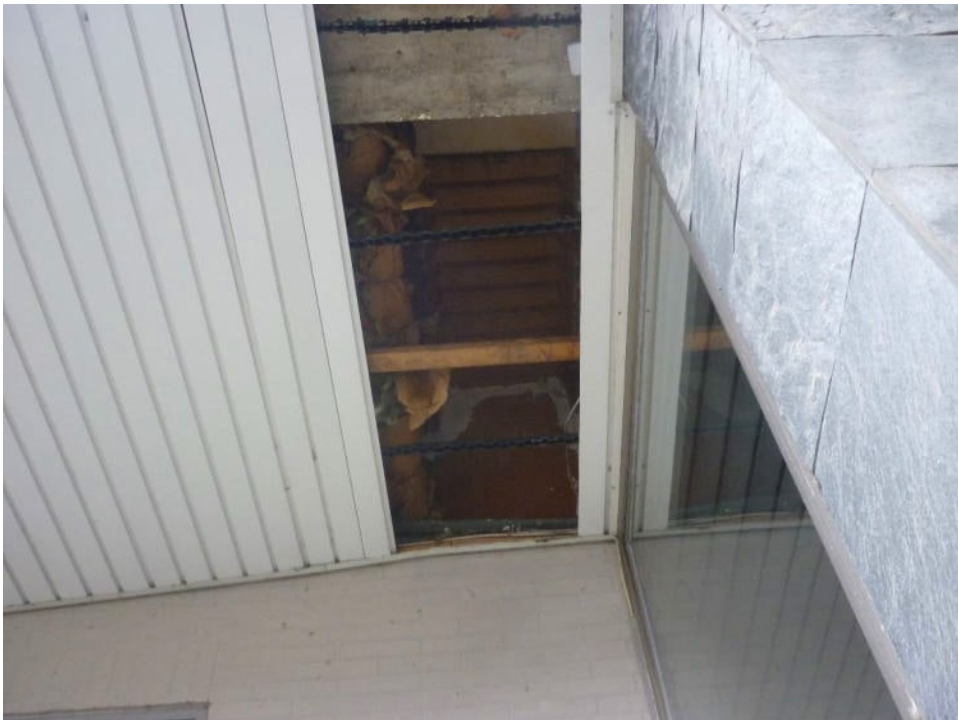
Abbildung 2-9: Defekte Deckenverkleidung an der Front des Ladengeschäfts. Hier gibt es mehrere Stellen an denen Deckenlamellen fehlen.
