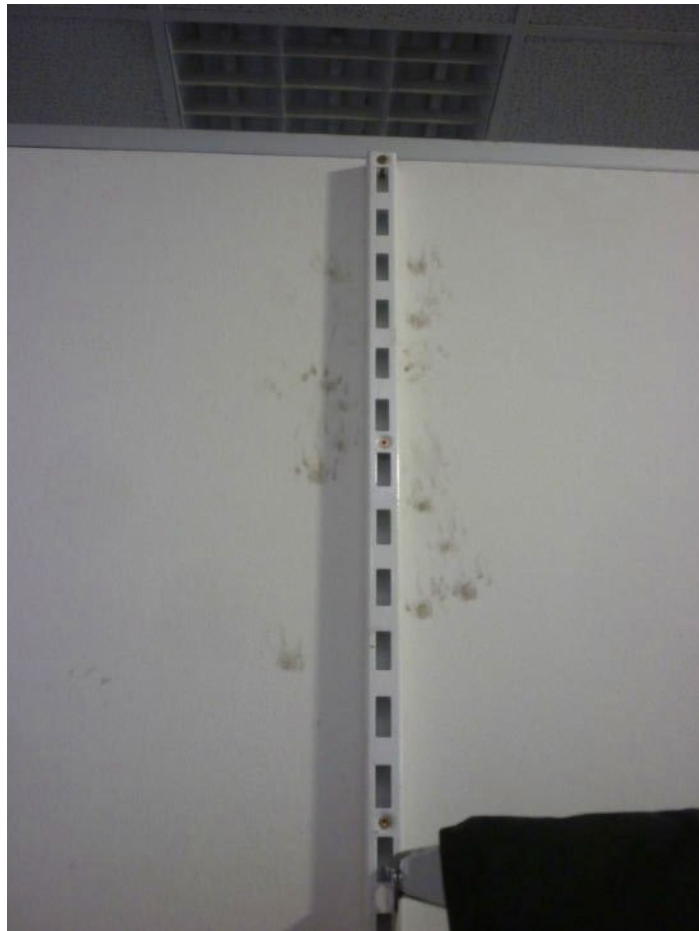
Abbildung 2-14: Bild aus dem Ladengeschäft. Hier sind bereits öfter Waschbären durch die Decke gebrochen und waren im Geschäftsraum gefangen. Hier sind Fußabdrücke eines Waschbären an einer Aufstellwand zu sehen
